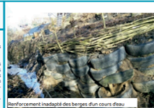
Renforcement inadéquat des berges d'un cours d'eau
