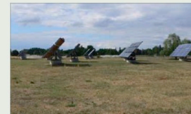
⑥ Champ de panneaux photovoltaïques
